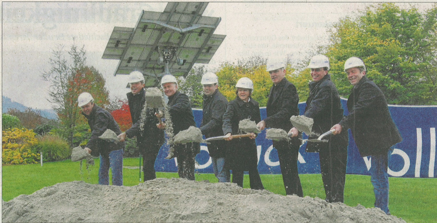
Symbolischer Spatenstich für drei Millionen Euro teuren Anbau der Gengenbacher Spitzmüller AG: Projektleiter Mirko Rink (von links), Rainer Kracht von der Geschäftsführung der Baufirma Vollack, Architekt Bernd Kempgen, Markus Spitzmüller, Ursula Spitzmüller, Rudolf Spitzmüller, Landtagsabgeordneter Volker Schebesta und Bürgermeisterstellvertreter Markus Dreher.
