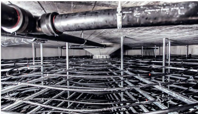
KLEIN ABER FEIN: Arnold Schmid vor dem unscheinbaren Kontrollhäuschen des Kalt-Wärme-Netztes. Darunter befindet sich das 340 Kubikmeter Wasser fassende Herz der Anlage, der Eisspeicher
